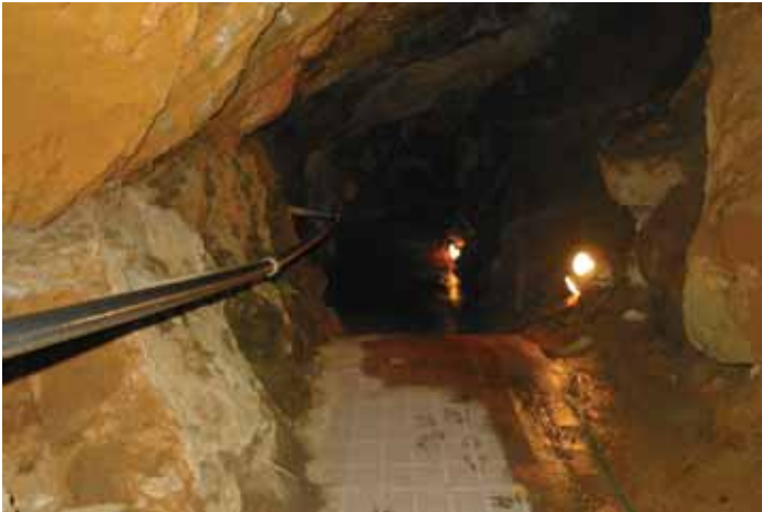
Figura 2. Entrada del túnel en la que se ven los cables de comunicaciones.
